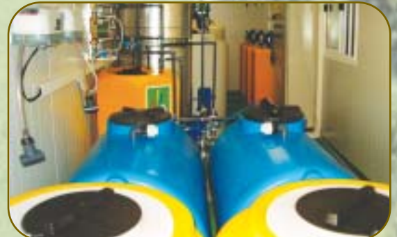
Impianto per il trattamento reflui da cantina vinicola
