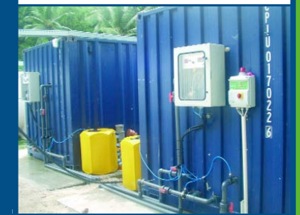
Trattamento reflui - 100 m 3 /d Uffici e alloggi
