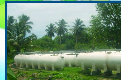
Trattamento reflui - 300 m 3 /d Centro logistico
